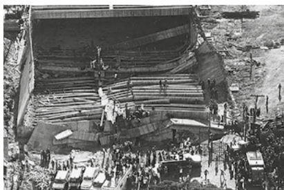
Desabamento do pavilhão da Gameleira, em Belo Horizonte: colapso das lajes causou 69 mortes
